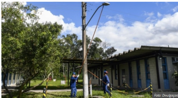
Flipposte - startup faz projeto que facilita troca de pontos da iluminação pública
